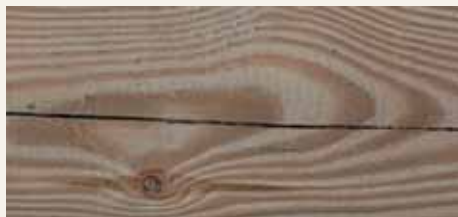
Spannungsrisse durch die Holz Trocknung
