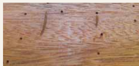
„Pinholes“ bei überseeischen Harthölzern
